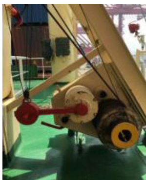
图3 救生艇绞车控制装置
