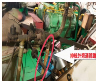
图2 私自安装直排软管
