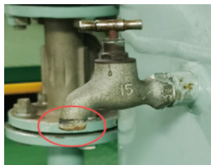
图 6 打开上部水位考克无水流出
